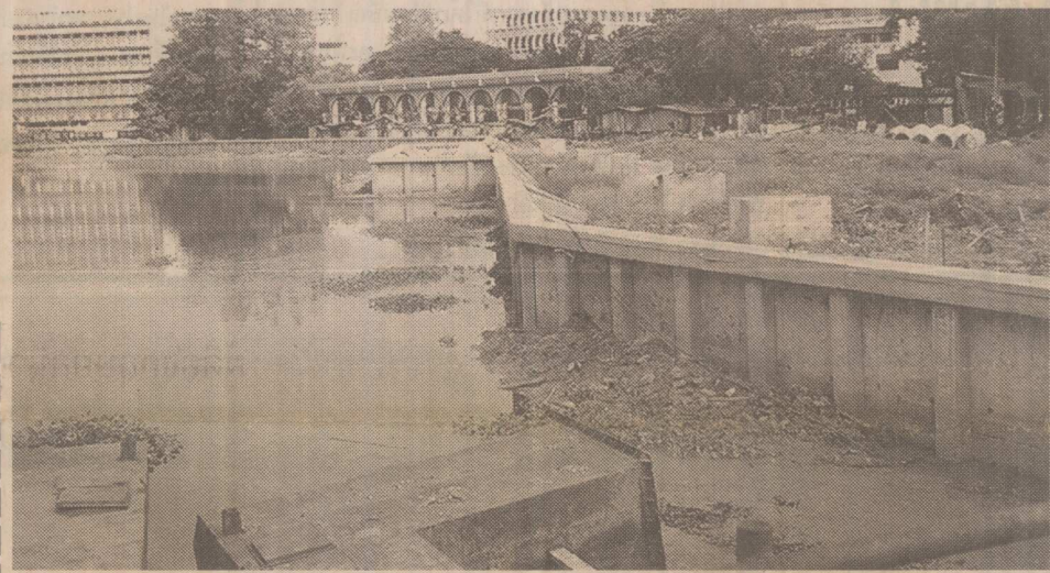
สภาพเขื่อนบริเวณที่ตั้งขุมนักศึกษาที่โดนรื้อ ซึ่งนายก อ.ศ.ม.ร. ระบุว่าแค่เริ่มก่อสร้างฐานเขื่อนก็มีรอยร้าวจนไม่สามารถสร้างต่อได้ อาจมีการทุจริตในการรับเหมา
