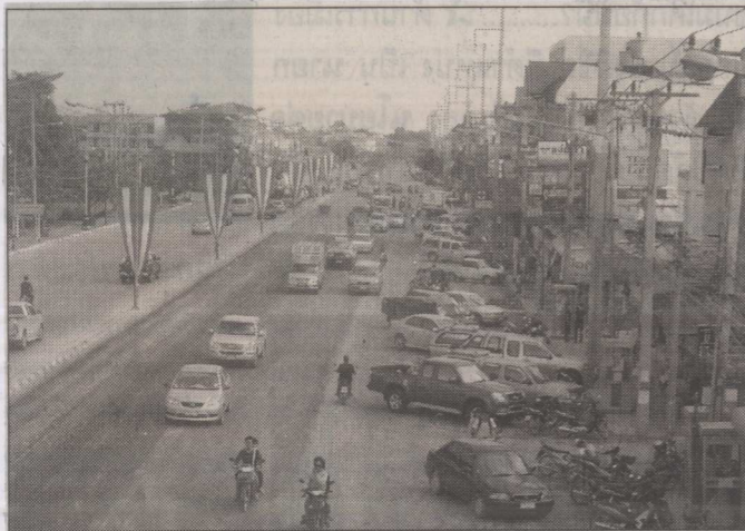
* ซ่อมถนนแม่โจ้... แขวงการทางที่ 2 เชียงใหม่ กำลังดำเนินการซ่อมผิวถนนสายเชียงใหม่ แม่โจ้ จาก กม.9 ถึง กม.11 ผ่านหามแม่โจ้ วงเงินกว่า 11 ล้านบาท เดือนผู้ใช้เส้นทางสัญจรผ่านไปมาระมัดระวังด้วย
