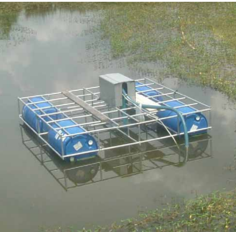
▼ ปั๊มน้ำมอเตอร์ 3 แรง ติดตั้งบนแพขนาดเล็ก
