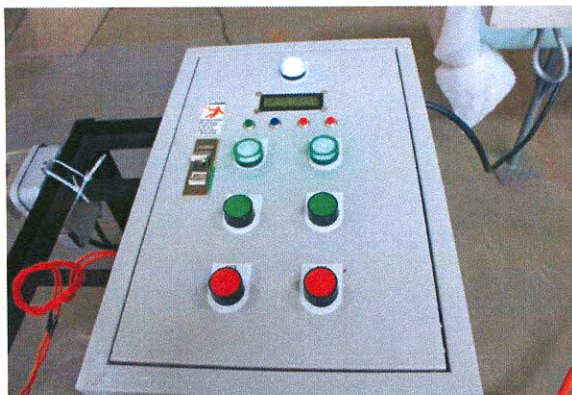
ภาพผนวก 4 ตู้ควบคุมปริมาณเชื้อเพลิงอิเล็กทรอนิกส์
